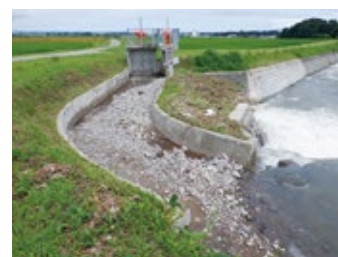
大口頭首工土砂堆積
