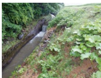
寺川用水路法面崩落
