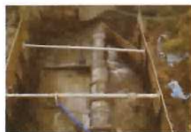
片向揚水機場
